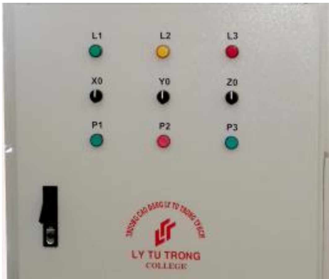
Hình 5.7. Các thiết bị trên cửa tủ điện
